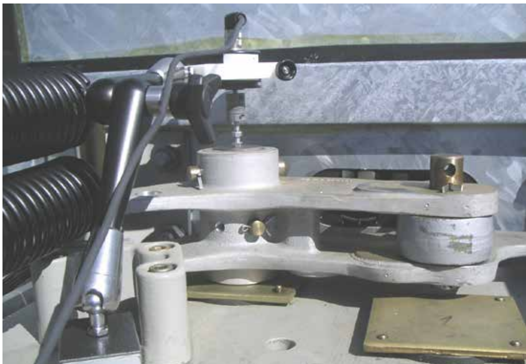
Mesure du mouvement dans le mécanisme du disjoncteur
